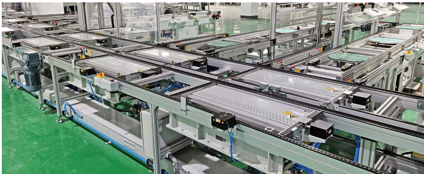
Sistema de control del transportador de pallets
