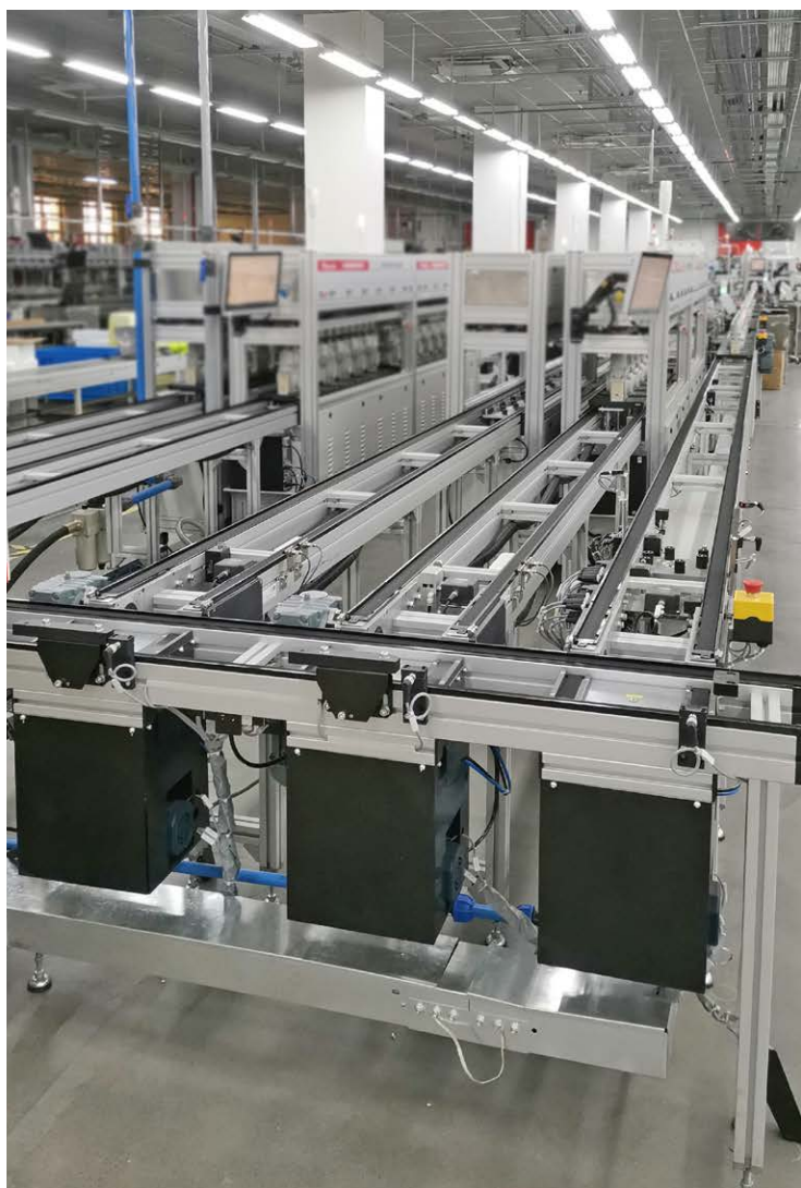
Sistema de control del transportador de pallets
