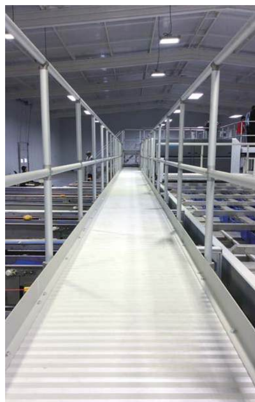
Puente (paso de gato) para Transportador
