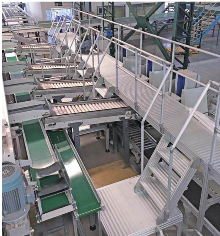
Puente (paso de gato) para transportador
